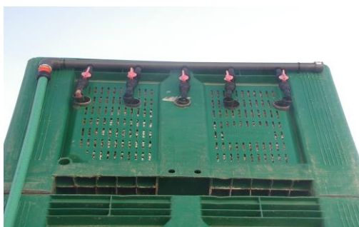
Figura 5.- Líneas de goteros
