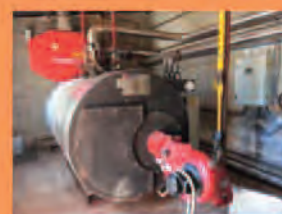
Pre calentamiento de agua de caldera
