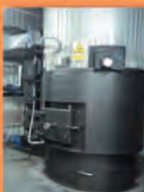
Caldera agua caliente
