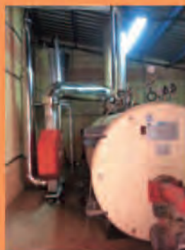
Recuperación de calor
