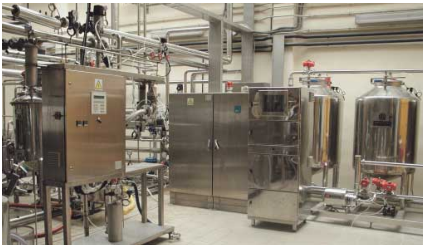
Vista general Planta Piloto.
