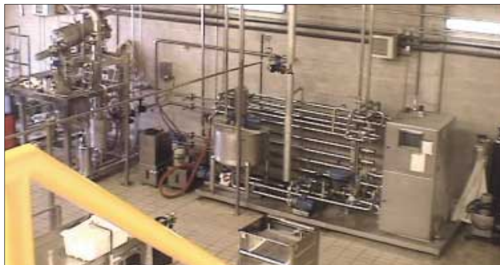
Imagen de la planta piloto del CTC
