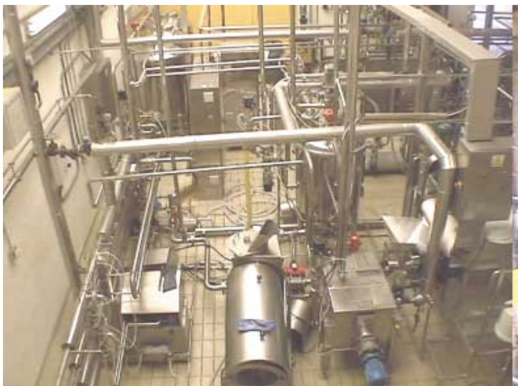
Imagen de la planta piloto del CTC
