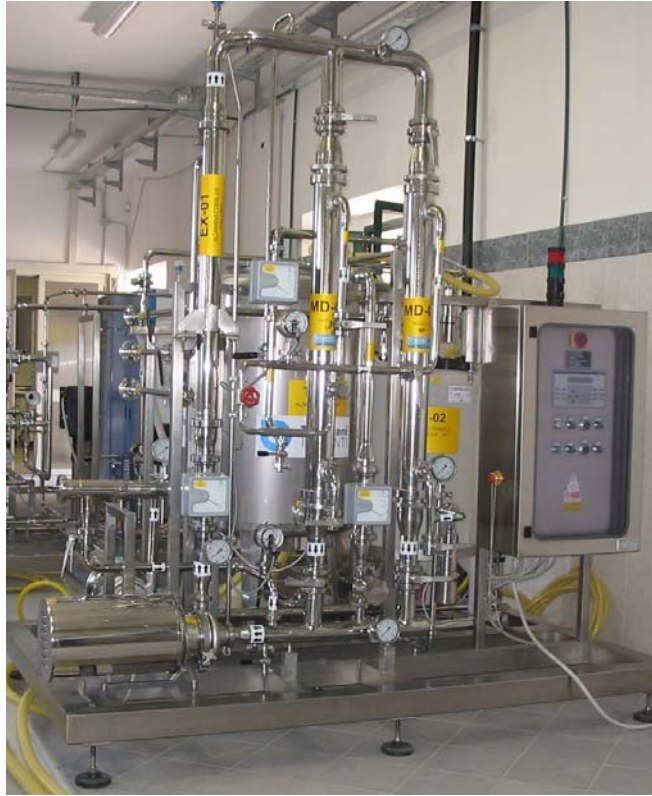
Figura 1. Planta piloto para tratamiento de OMWW: sección de microfiltración de membrana cerámica.
